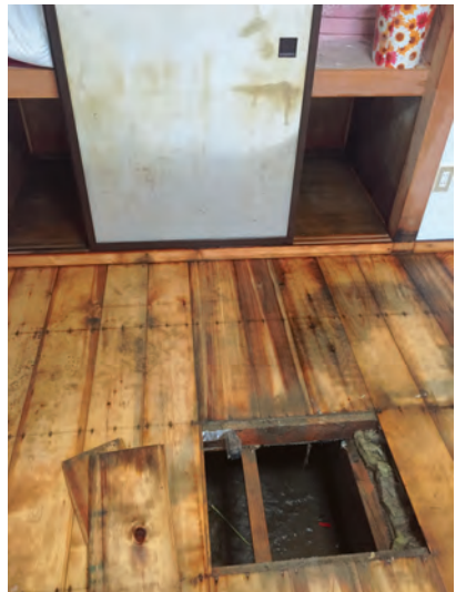
室内の被害状況も撮っておく
