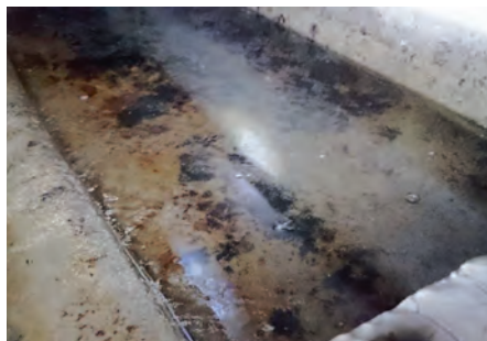
水が残って悪臭が発生する
